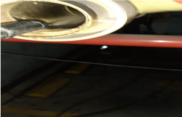
Colector aéreo costado sur
