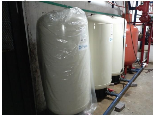
TANQUES HIDROFLO PEARL NUEVOS
