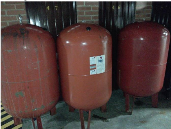
TANQUES HIDROFLO IHM DAÑADOS
