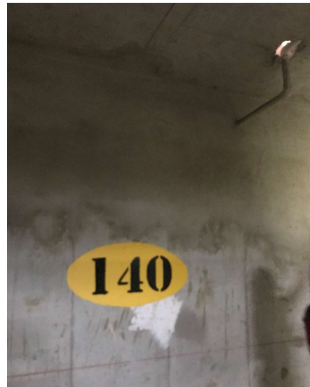
Afectación en placa
