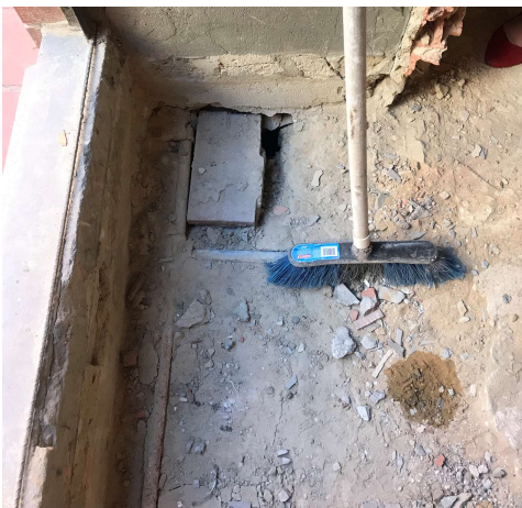
Afectación en placa
